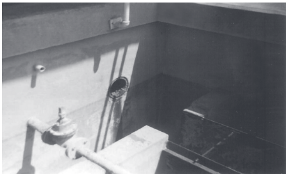
Fig. 6. Vista parcial de la galería de filtros de la fase I con presencia de degradación metálica en sistema de llenado planta de tratamiento "Angostura" ubicada en Ciudad Bolívar.
