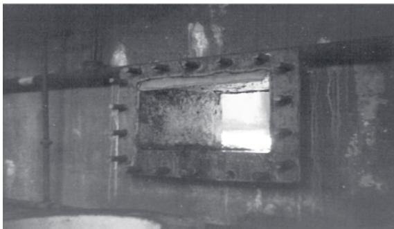
Fig. 7. Vista parcial de uno de los accesos de drenaje de la galería de filtros de la fase I fuertemente corroida en la planta "Angostura" ubicada en Ciudad Bolívar.
