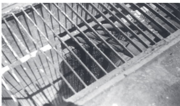
Fig. 3. Vista parcial de fosa y sistema de drenaje anexos al sistema de dosificación de la fase I, en la planta de potabilización "Angostura" ubicada en Ciudad Bolívar.
