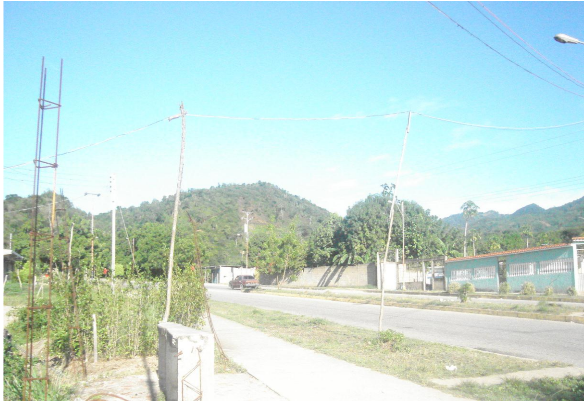
Postes inadecuados (ramas de árboles o arbustos) utilizados para la distribución eléctrica y la toma de un poste de alumbrado público de la comunidad de Andrés Bello.
