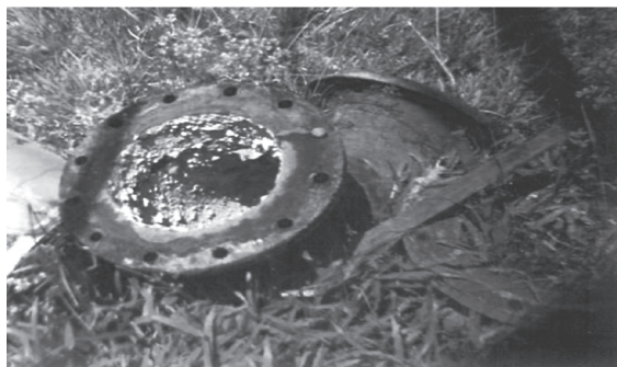
Fig. 11. Vista parcial de un codo de 90° con diámetro exterior de 12 pulgadas, fuertemente incrustado con carbonato de calcio, en la planta de tratamiento "Angostura" ubicada en Ciudad Bolívar
