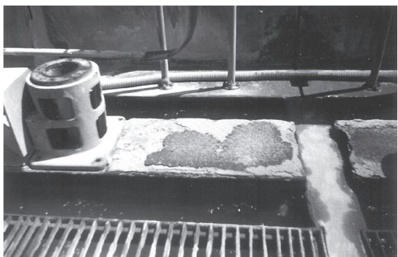
Fig. 4. Vista parcial de tanquilla de remoción rápida fuertemente corroída, perteneciente a la fase II de la planta de tratamiento "Angostura" ubicada en Ciudad Bolívar.
