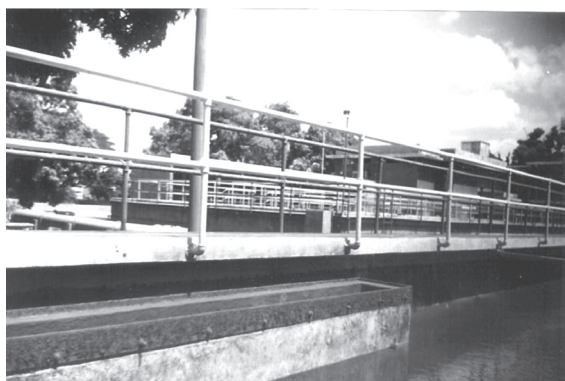
Fig. 5. Vista parcial del canal de salida de fosa de sedimentación parte externa, muy corroída y perteneciente a la fase II de la planta de tratamiento "Angostura" ubicada en Ciudad Bolívar.
